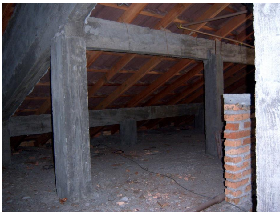
Figura 32 – Estrutura de telhado com pontaletes e terças de concreto moldado no local
